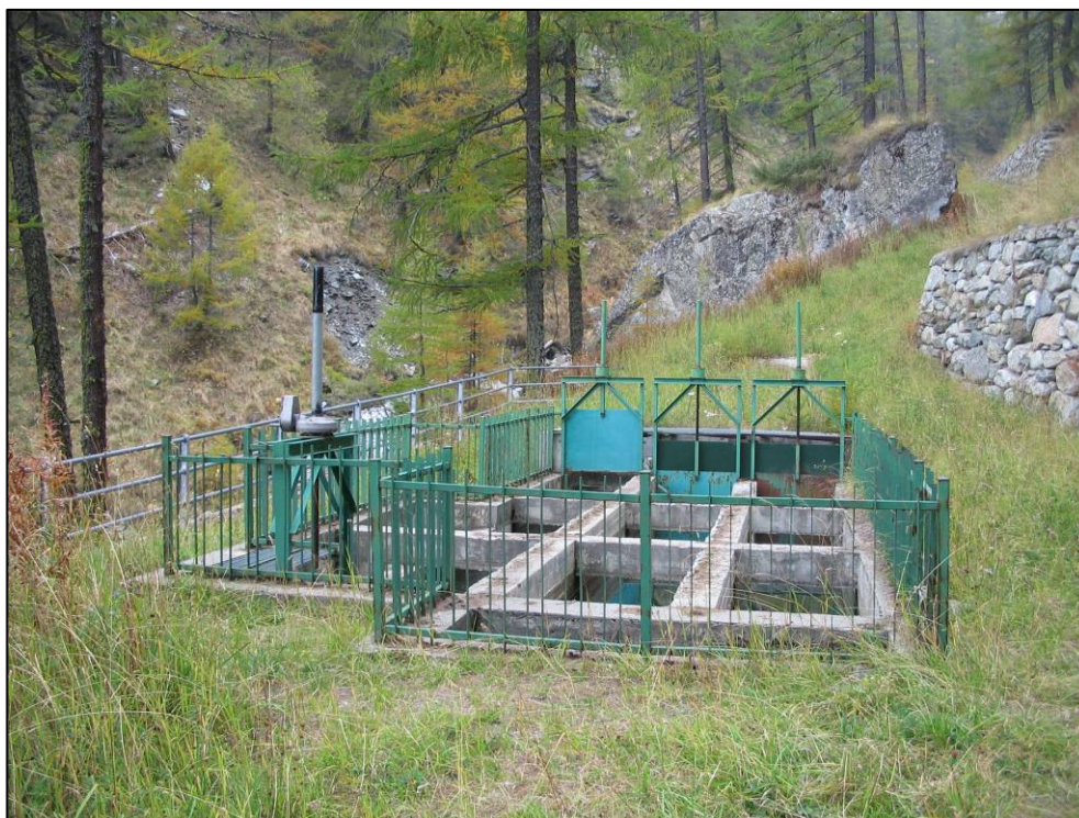
Figura 1: dissabbiatore esistente a servizio del Ru d'Allein ubicato nei pressi del torrente Menouve
